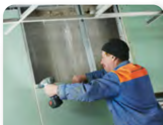
Veel voorkomende schades in de droge afbouw
